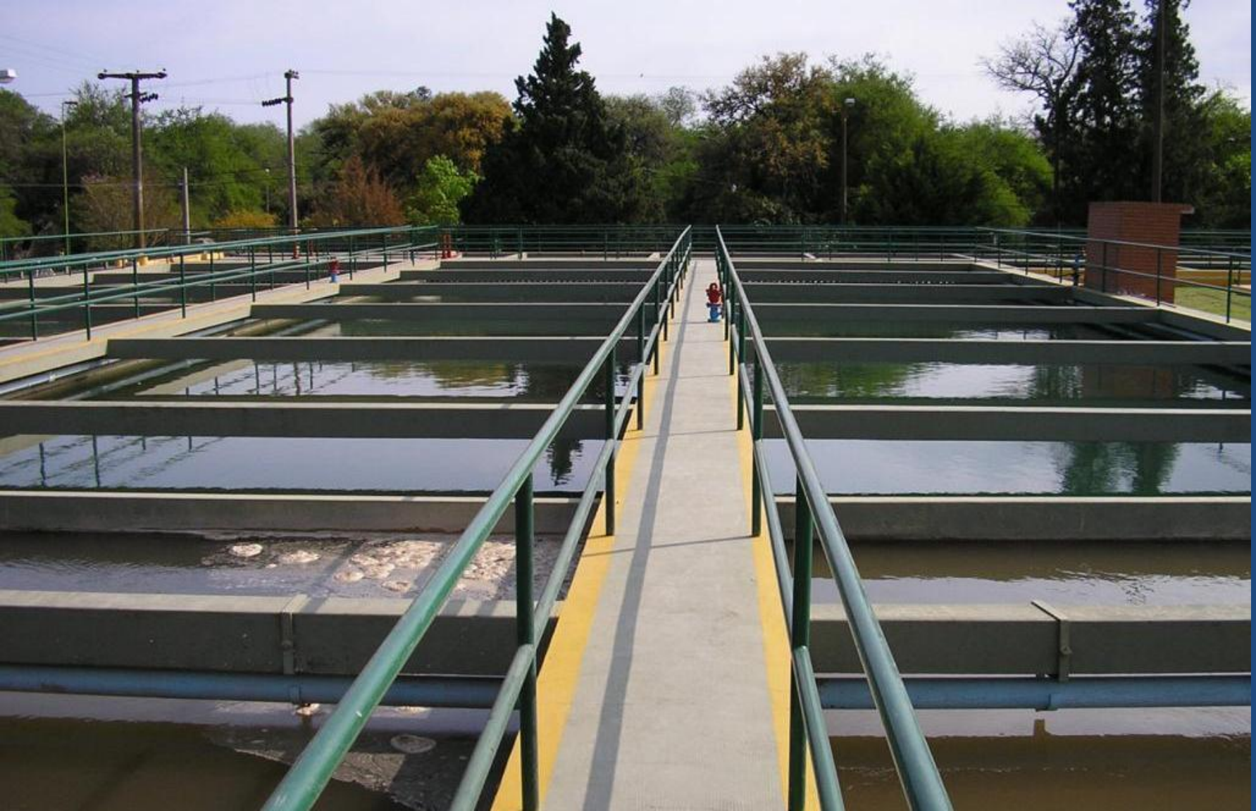
Piletas de decantación
